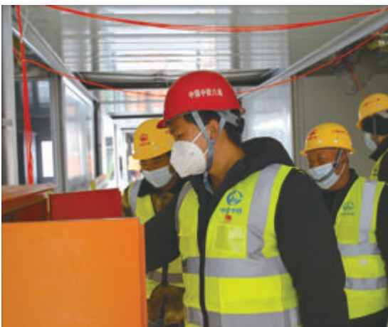
中国中铁六局基层正在对配电箱进行例行安全检查
