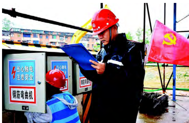
现场巡查安全用电情况
